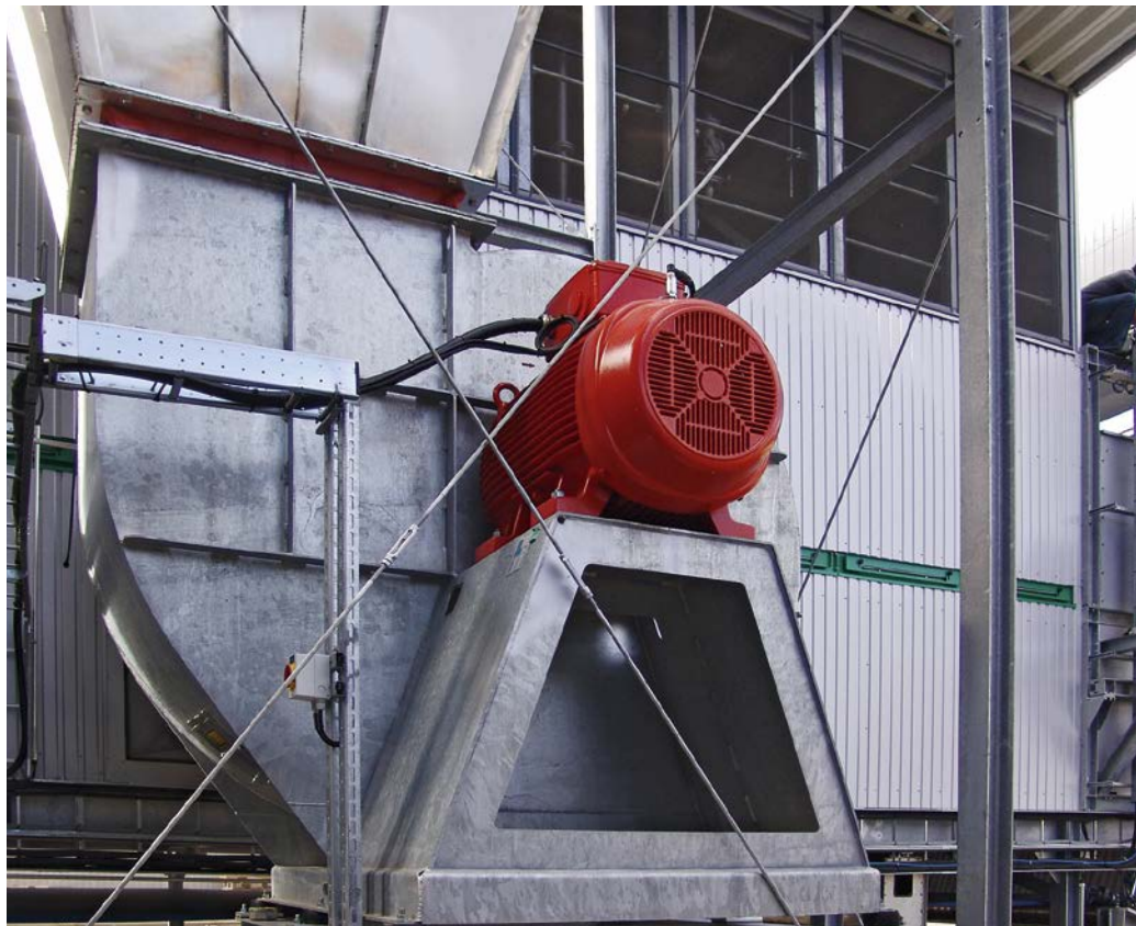
Abluftventilator mit drehzahlregelmäßigem Antrieb
