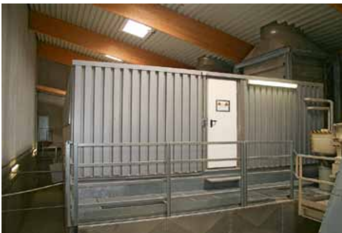
Der Bandtrockner von Stela Laxhuber mit der Multi-Vent-Technologie ist 18 m lang und wurde aus Lärmschutz-Gründen im Gebäude eingebaut
